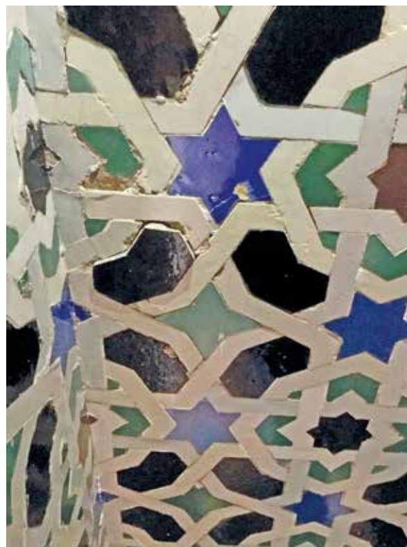
Figura 8. Detalle en el que se aprecia alicer desprendido del soporte.
