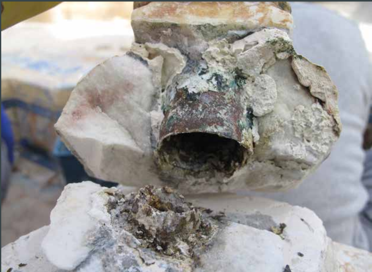
Figura 43. Estado de la tubería interior, fracturada por oxidación. (Crest Arte)
