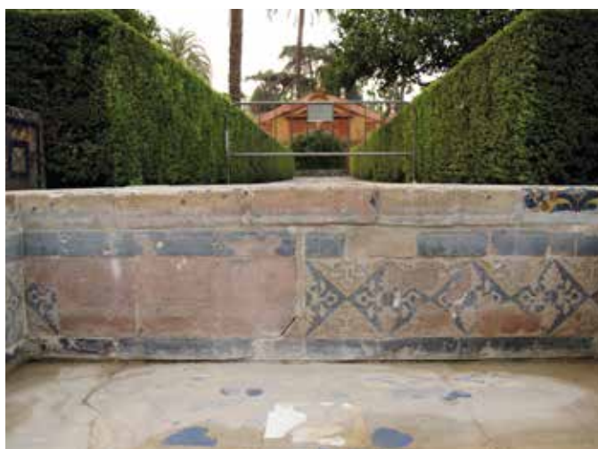
Figura 10. Fuente este, murete sur del vaso. Pérdida de morteros de sellado en grietas y uniones de piezas. Falta de estanqueidad. Ocultación parcial de diseños por velos calcáreos. (Crest Arte)
