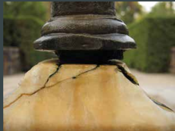
Figura 14. Fuente este. Detalle del pedestal de mármol fisurado por el encastre del surtidor de latón. (Crest Arte)
