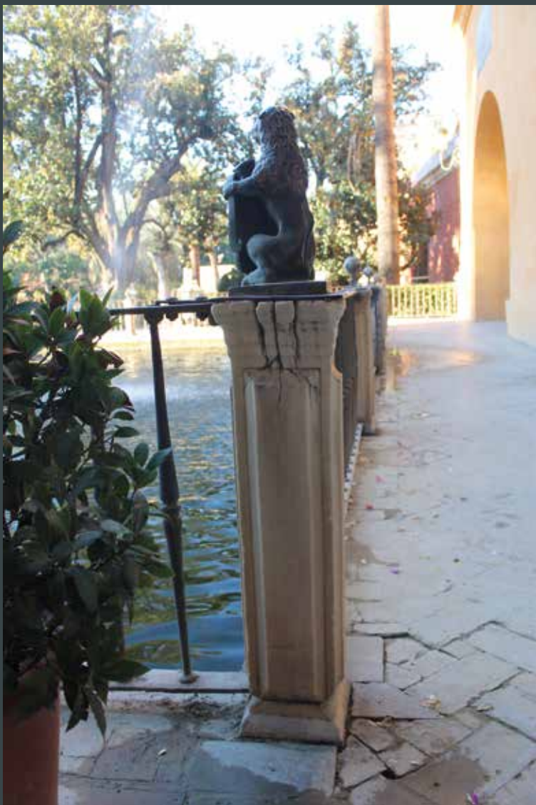
Figura 9. Cortes y grietas en el pilar (n° 1) de la esquina Noreste (Perla/Peña).
