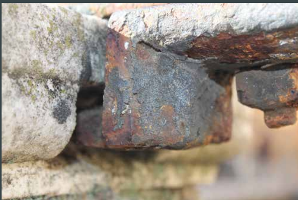
Figura 20. Oxidación y corrosión del hierro y presencia de restos de pintura de oxirón envejecida en un punto de sujeción de la pletina superior. (foto Perla/Peña).
