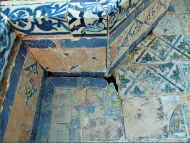
Figura 38. Fuente oeste. Eliminadas las costras aparecen profundos agujeros en el suelo por desajustes entre piezas restituidas. Bajo estos agujeros hay raíces. (Crest Arte)
