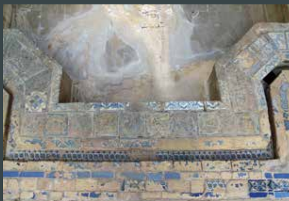
Figura 15. Fuente oeste, lado norte. Costras estromatolíticas que cubren completamente el estanque, debido al uso de agua excesivamente calcárea. La azulejería del pretil es producto de restituciones contemporáneas, en las que se ha incorporado piezas no coetáneas y de distintos diseños. (Crest Arte)
