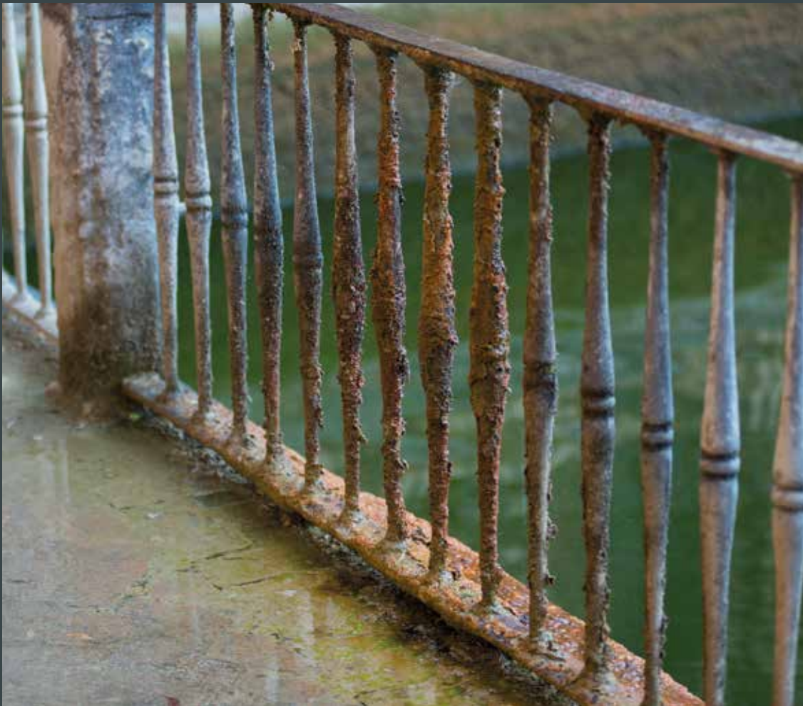
Figura 14. Corrosión y precipitación en el tramo de balaustrada entre los pilares XX y XXI en el lado Norte.(foto Nacho Pérez).
