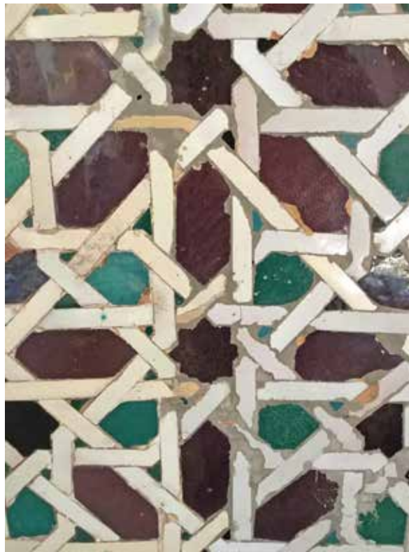
Figura 7. Detalle de alicatados con rejuntados de cemento.
