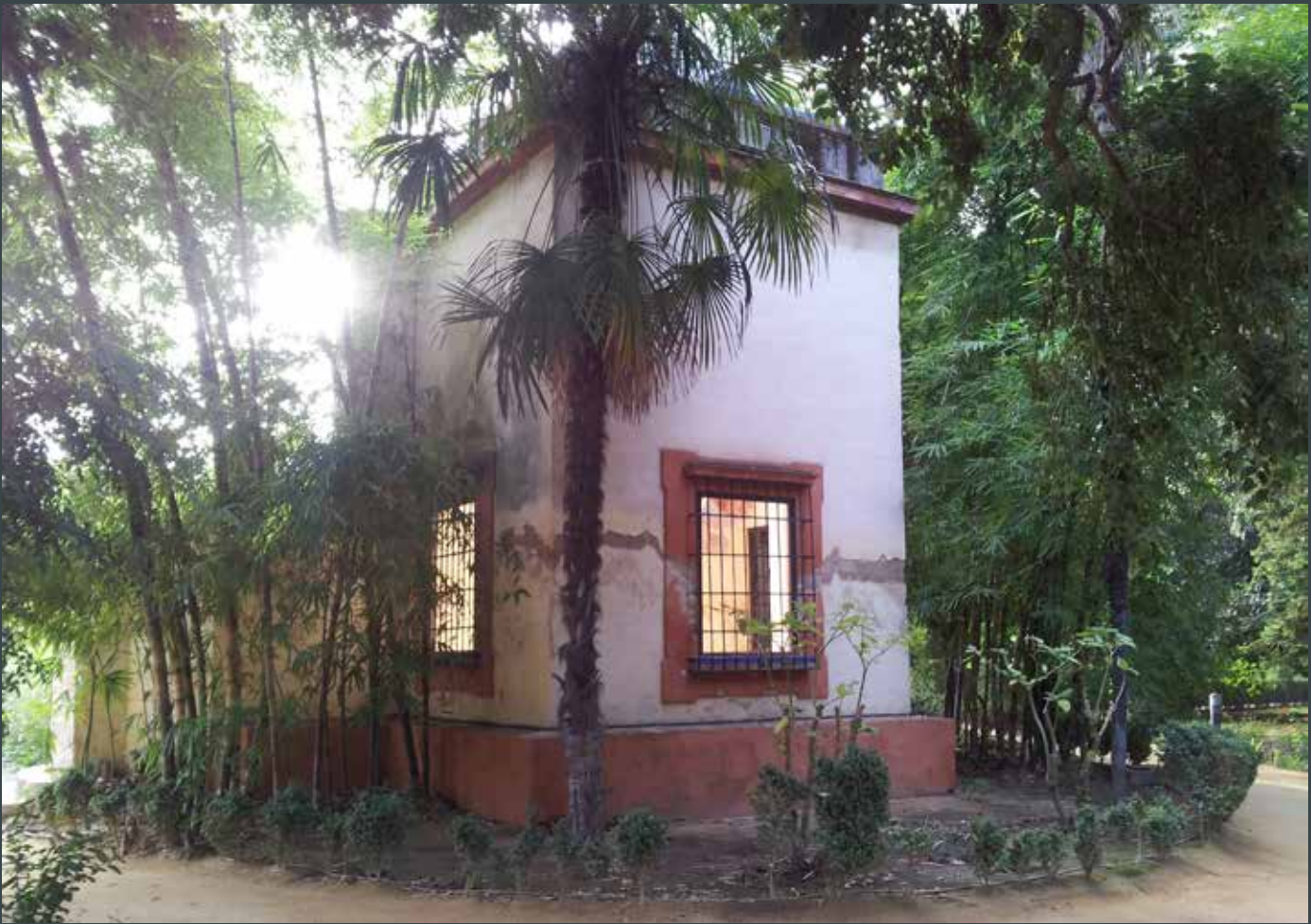
Figura 17. Humedad por capilaridad en los muros, humedad en el cuerpo superior del pabellón y en los muros bajo las cornisas.
