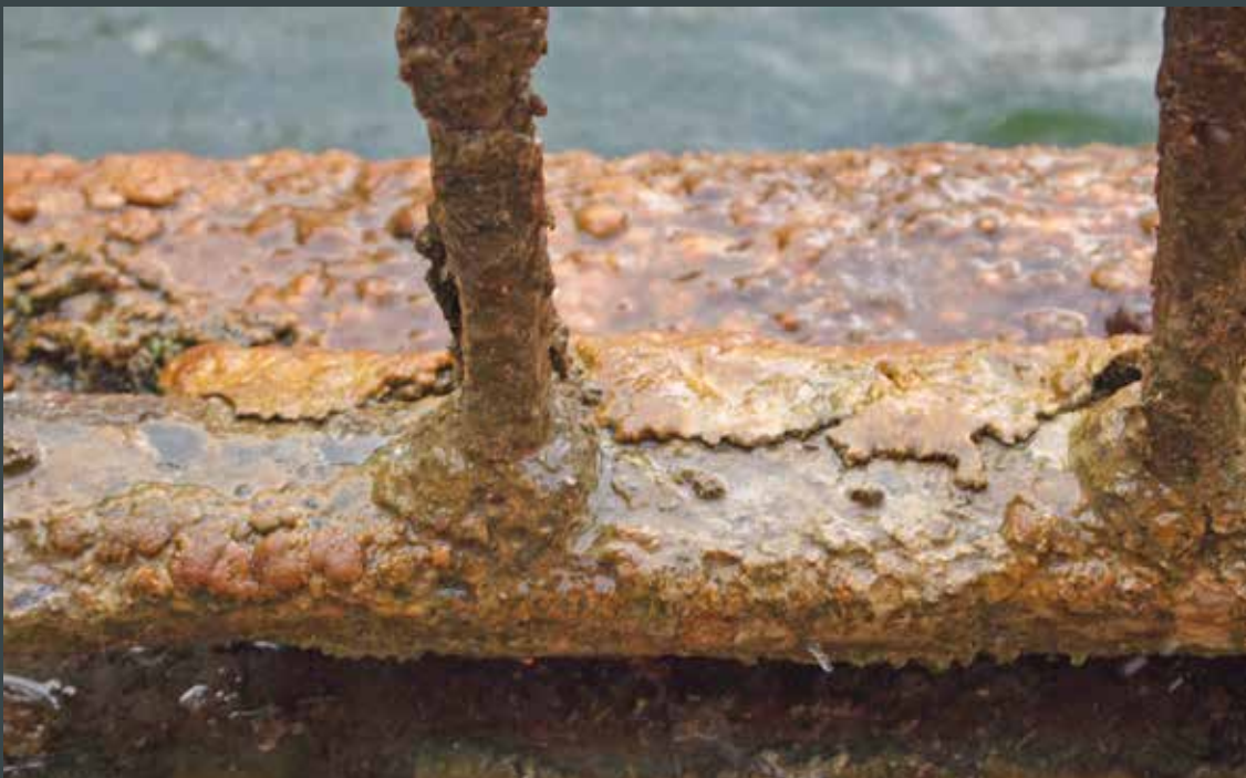
Figura 15. Detalle de costras de precipitación bioinducida y productos de corrosión. (foto Perla/Peña).
