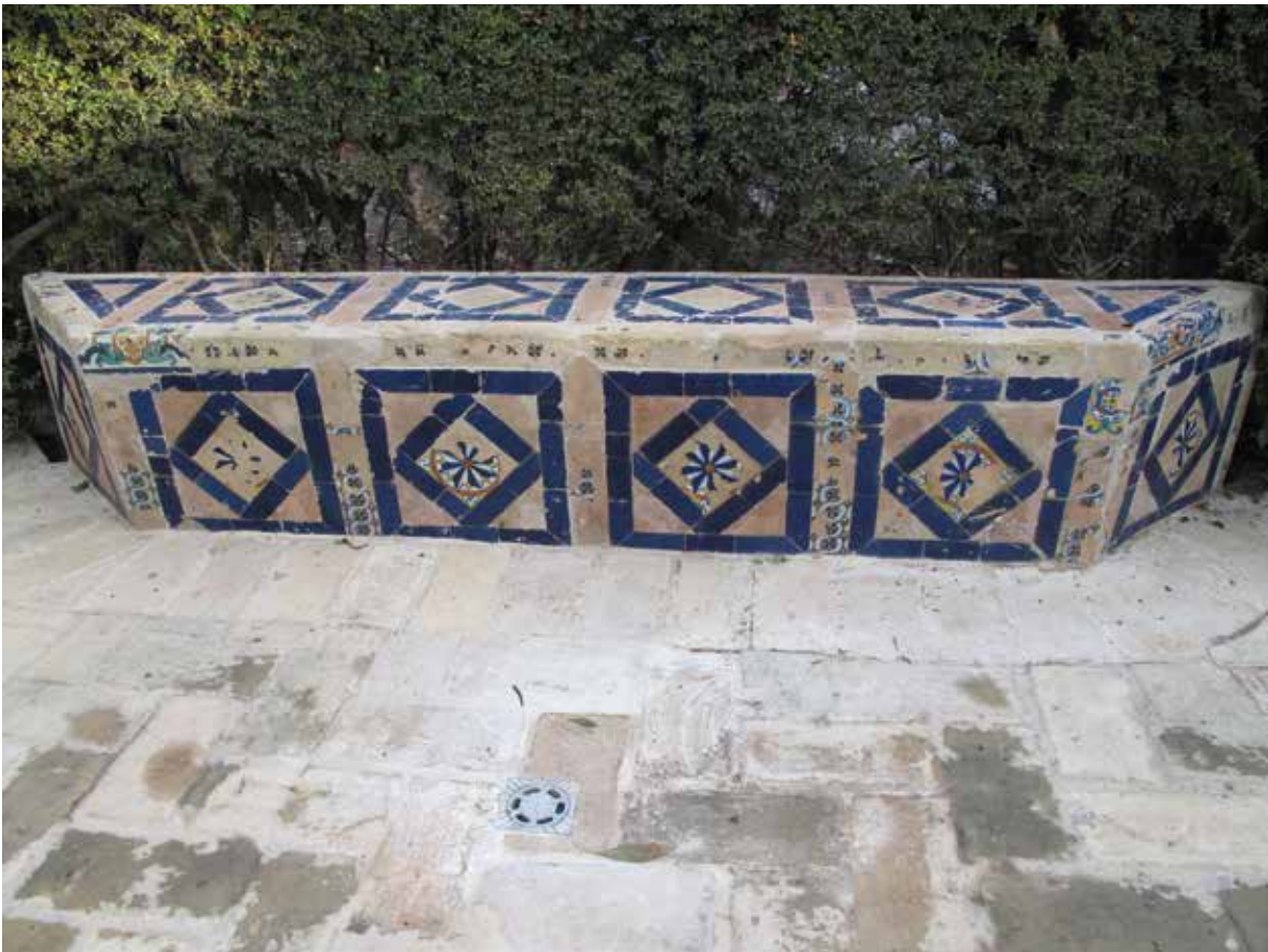
Figura 52-53. Glorieta oeste. Imagen comparativa del estado previo y final de uno de los bancos afectados por fractura estructural (NE). (Crest Arte)
