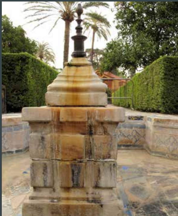
Figura 13. Fuente este. Estado previo del pedestal marmóreo y surtidor. (Crest Arte)
