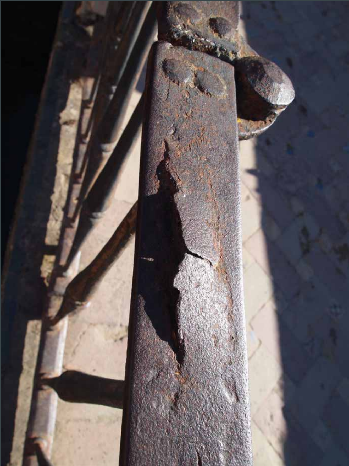
Figura 21. Laminación del hierro a causa de la corrosión en la cancela de la balastrada en el lado Sur. (foto Perla/Peña).
