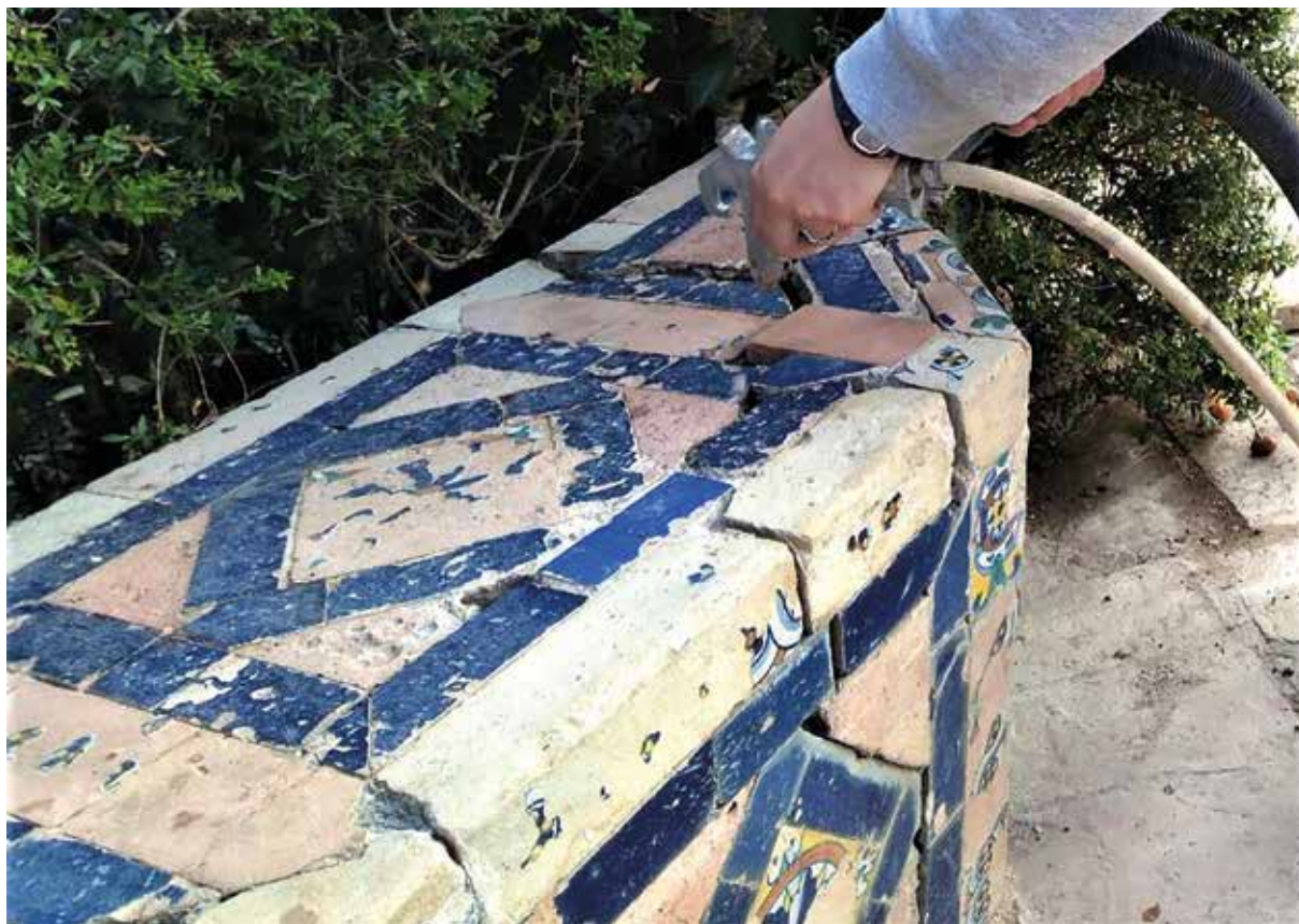
Figura 48. Banco de glorieta oeste. Eliminación de la suciedad alojada en la fractura estructural con pistola de aire. (Crest Arte)
