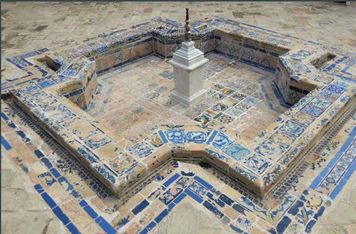
Figura 44. Fuente oeste. Terminación del pedestal y sellado completo de todas las juntas abiertas del material cerámico, con morteros de cal. (Crest Arte)
