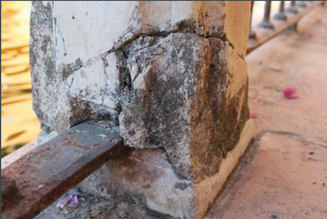
Figura 8. Zona de anclaje de la pletina inferior de la baranda en la base del pilar n° III en el lado Este (foto Perla/Peña).
