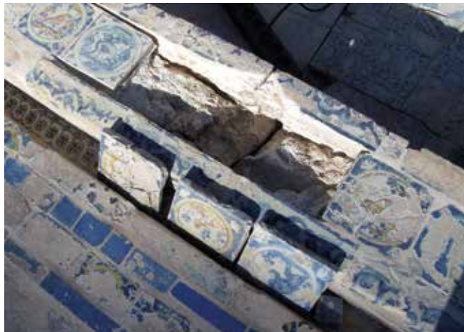
Figura 35. Fuente oeste, lado sur. Desmontaje de la azulejería del pretil por movimiento de piezas debido a desconsolidación y oquedades internas. Saneado, limpieza y montaje. (Crest Arte)
