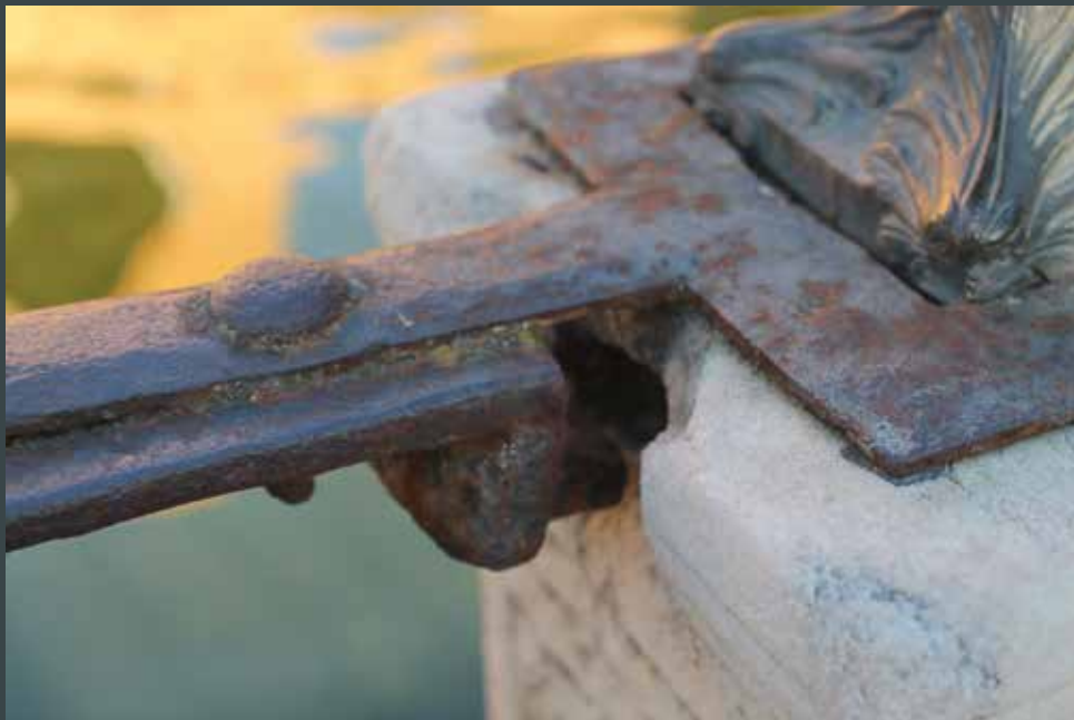
Figura 19. Pérdida de materia en la zona de anclaje de la baranda en el pilar nº XI (foto Perla/Peña).
