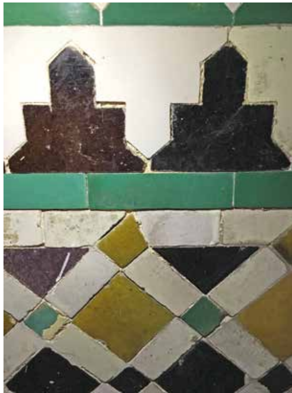
Figura 6. Detalle en el que se aprecia desgaste y suciedad superficial sobre los alicatados.
