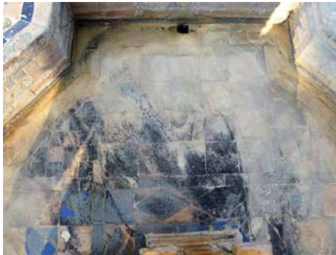
Figura 9. Fuente este. Estado previo. Patologías generadas por el agua del aljibe en las zonas de contacto prolongado. Fondo del vaso cubiertas por biocostras y costras calcáreas. Tinciones negras por cianobacterias. (Crest Arte)
