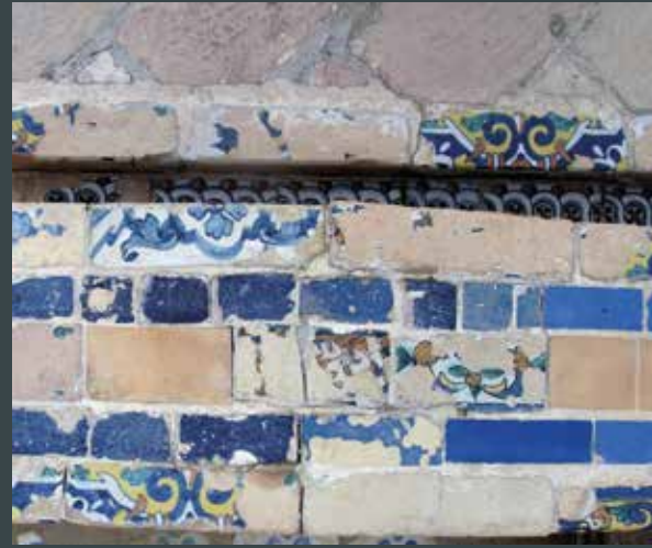
Figura 12. Fuente este, pretil sur. Uniones abiertas por movimientos del terreno. (Crest Arte)
