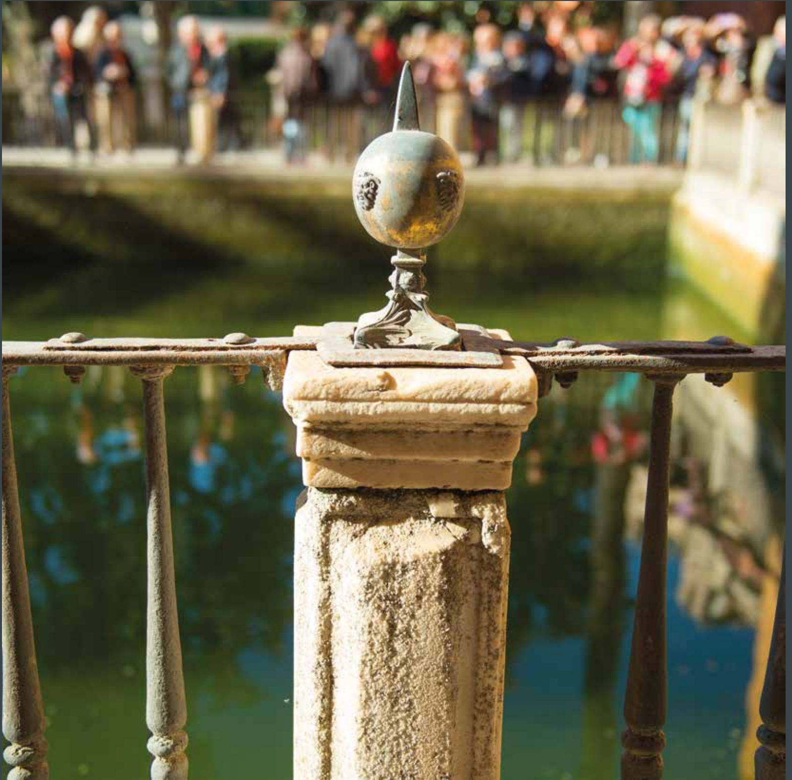
Figura 17. Degradación material diferenciada de las piezas de mármol del pilar nº II del lado Este.(foto Nacho Pérez).
