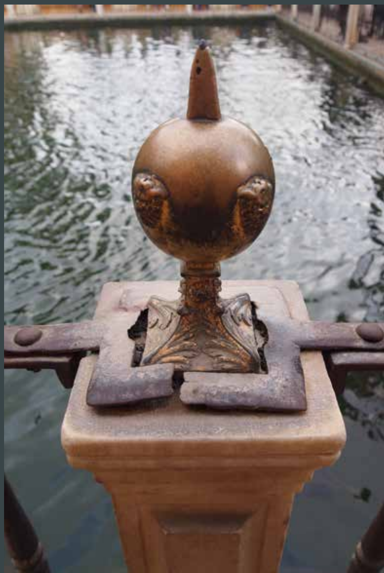
Figura 11. Fractura de la pletina de sujeción en el pilar n° XIX (foto Perla/Peña).
