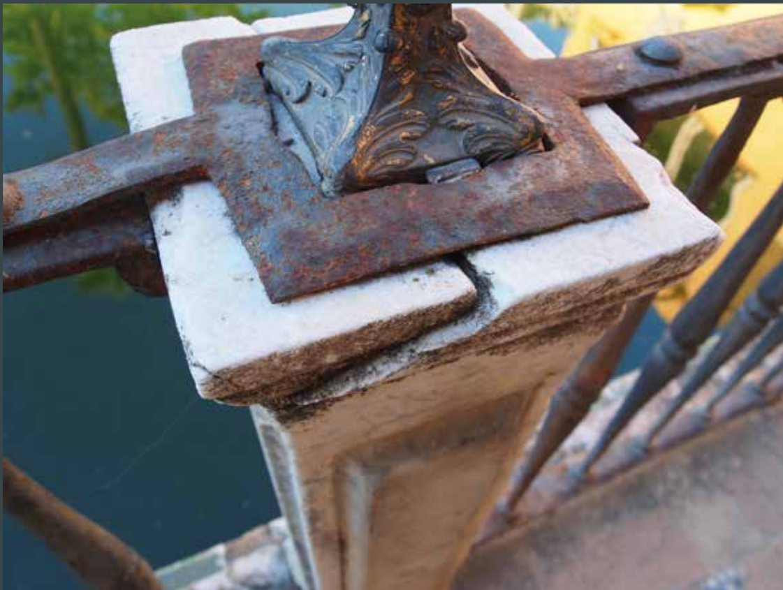
Figura 10. Fractura de la testa de un pilar (n° V) en el lado Este (foto Perla/Peña).
