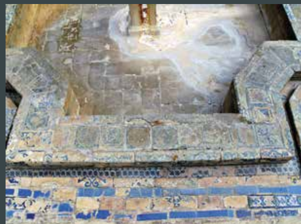
Figura 16. Fuente oeste, lado sur. Pésimo estado de la azulejería en general, con abundantes azulejos restituidos de distintas épocas y diseños, fijados y rejuntados con cemento. Invasiones calcáreas y estromatolíticas generadas por el tipo de abastecimiento. (Crest Arte)
