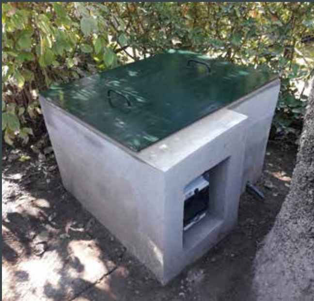
Figura 25. Caseita de obra que alberga la arqueta, provista de cuadro eléctrico. (Crest Arte)
